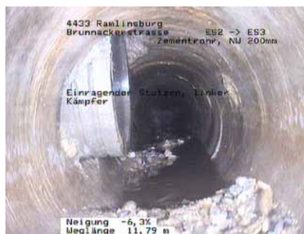
Nicht fachgemäss angeschlossene Hausanschlussleitung
