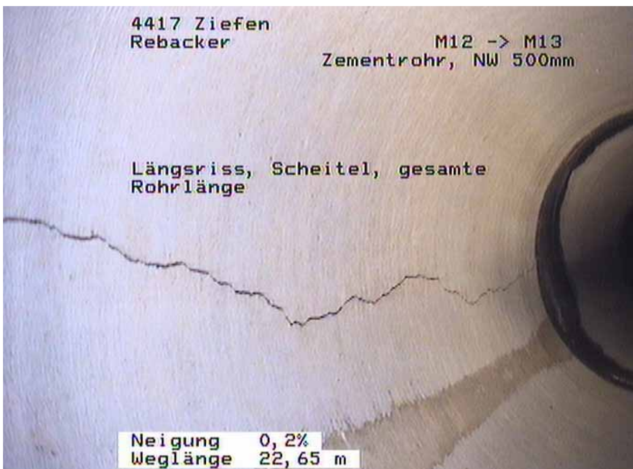
Rissbildung auf Grund äusserlicher Druckeinwirkung
