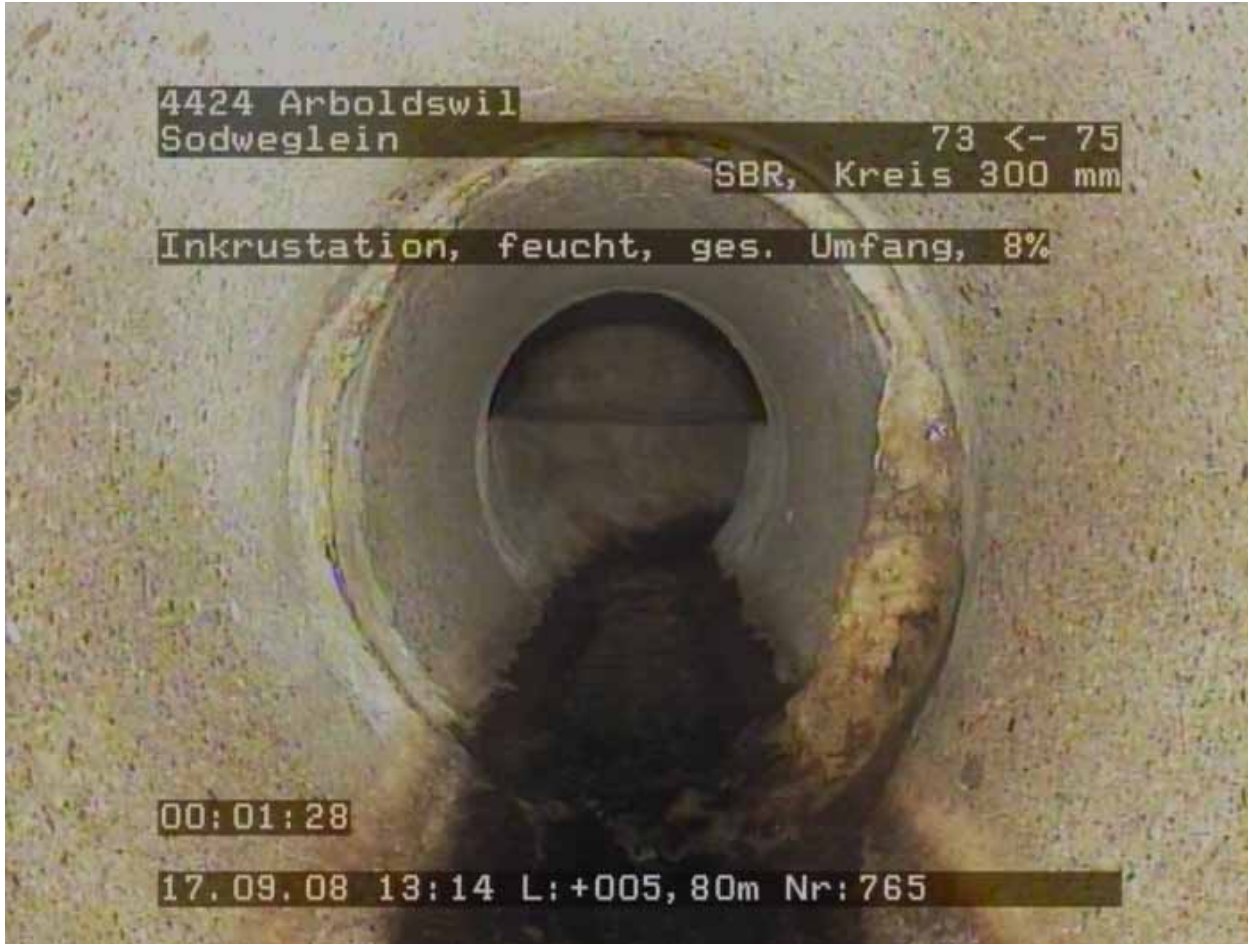
Undichte Rohrverbindung mit Verklarkung
